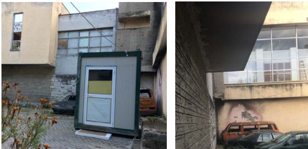
Figura 15.16 Gjendja ekzistuese e fasadës veriore. Evidentimi i degradimit të materialeve dhe lagështisë.
