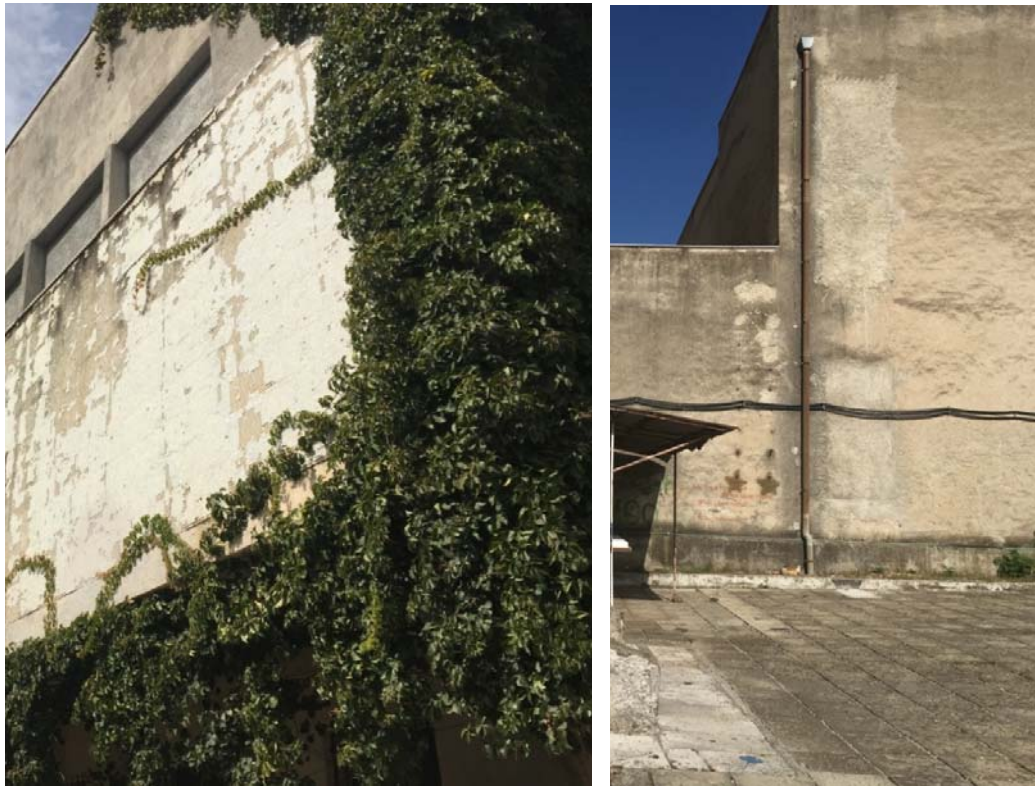
Figura 18.19. Gjendja ekzistuese e fasadës jugore. Evidentimi i vegetacionit dhe shkëputjës së mozaikut ne figurën majtas dhe lagështisë në fasadë në figurën djathtas.
